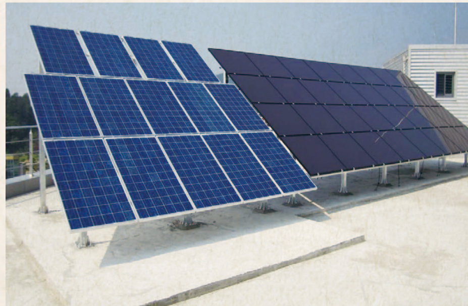
우리대학 미래창조관 옥상에 설치된 태양광발전시스템
